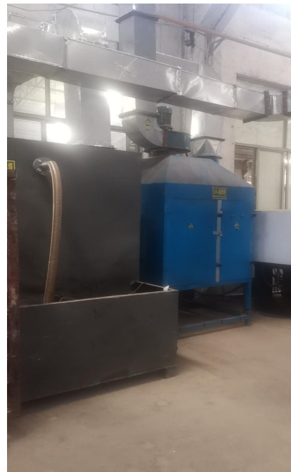
图 4-2 烘干废气处理设施
