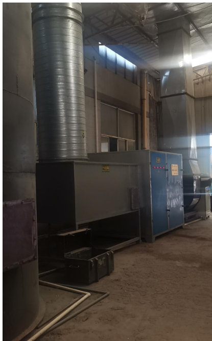
图 4-1 喷漆废气处理设施及其排气筒
