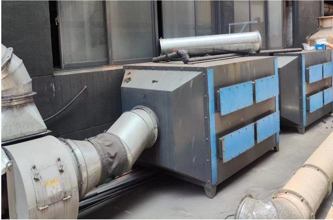
图 3-7 挤出废气处理设施现场照片
