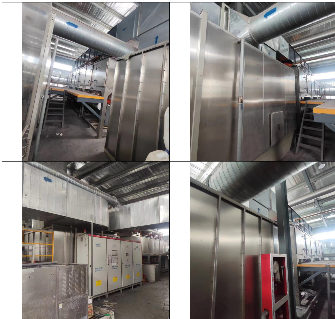
图 3-9 丝印、烘干、燃烧、喷漆废气处理设施现场图
