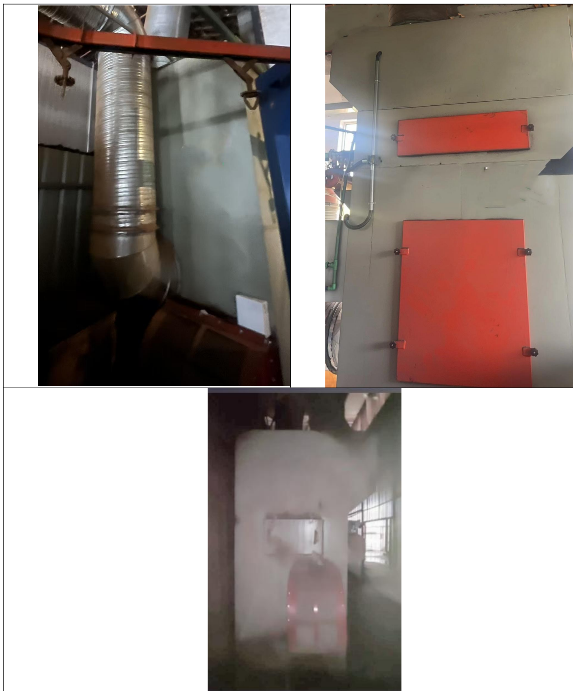
图 3-6 喷塑废气处理设施现场图
