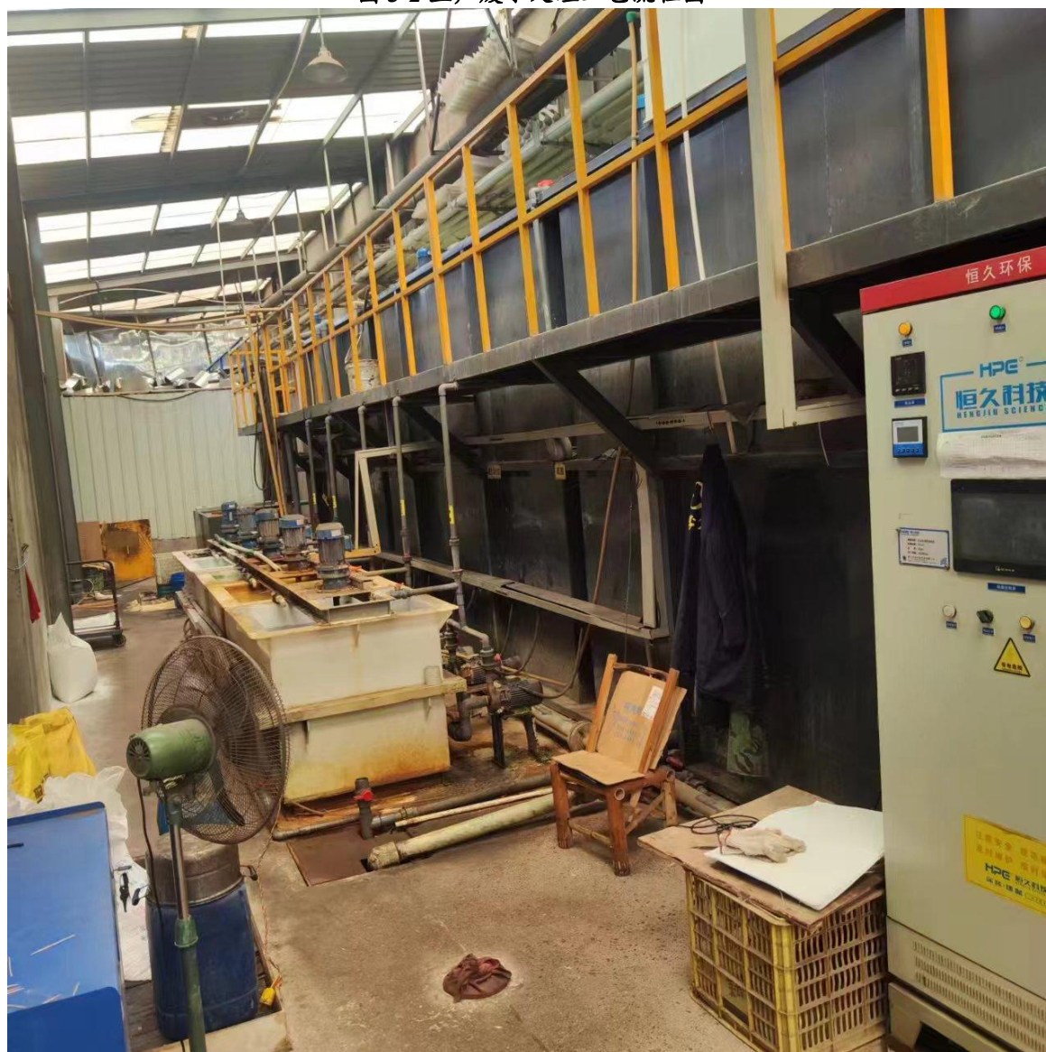
图 3-3 生产废水处理设施现场图
