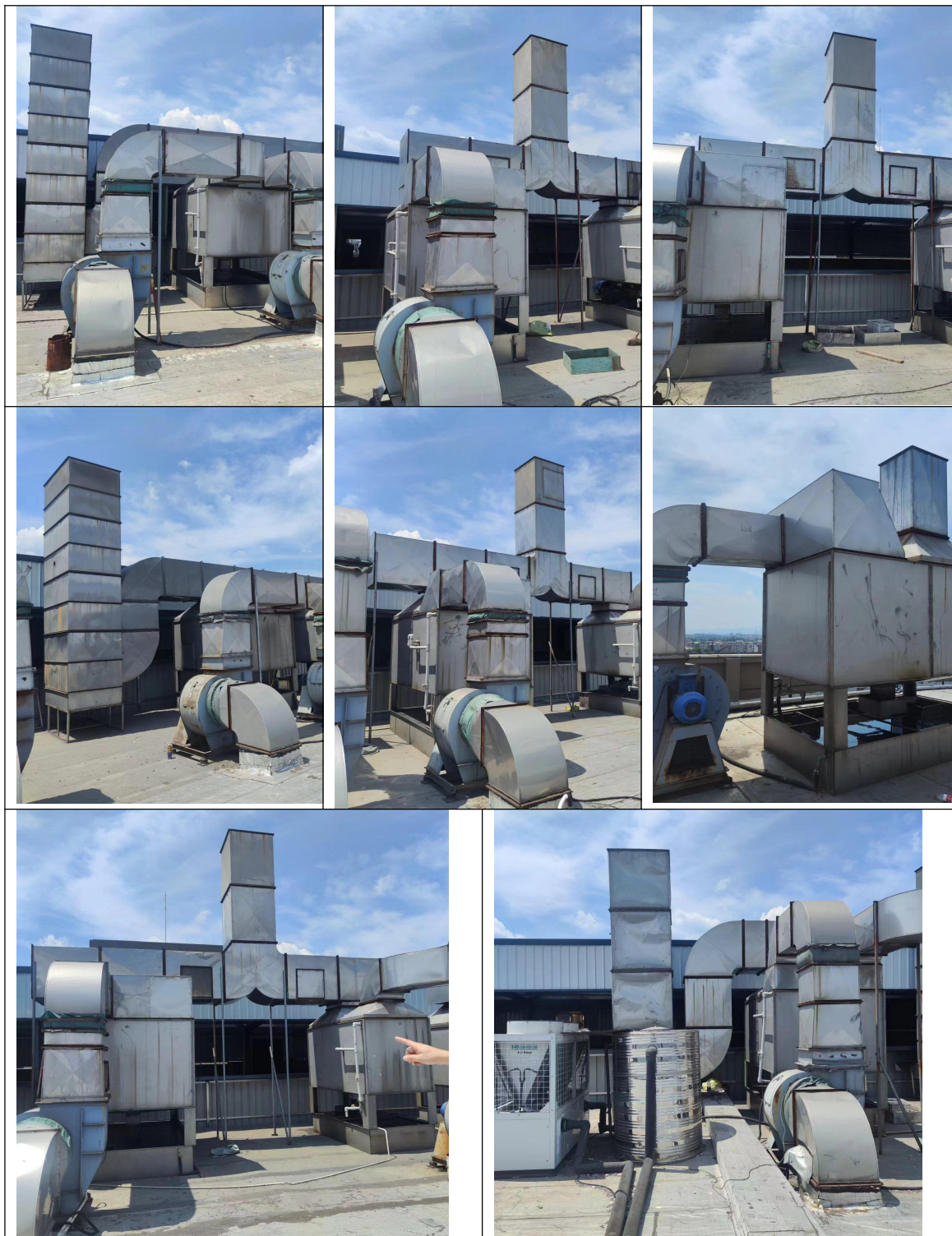
图 3-11 抛光废气处理设施现场图
